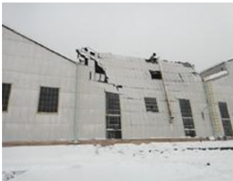
雪害直後の屋根が崩壊した工場
