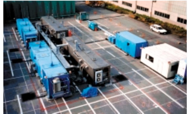
写真1 施設設置状況 Layout of treatment units
