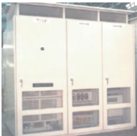
(a) パワーキッカーが搭載された変電装置 Power equipment for substation.
