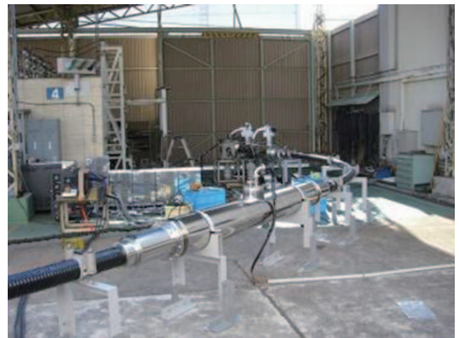
図8 66 kV 3 kA イットリウム系超電導ケーブルの短絡試験（ジョイントの手前が住友電工製超電導ケーブルで、奥の超電導ケーブルとジョイントが古河電工製） Short-circuit current test of the 66 kV-3 kA YBCO HTS cable (A cable joint, and a 10 m cable that was set in the back from the joint were fabricated by FEC).
