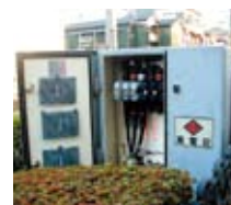
屋外電気設備
