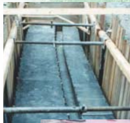
電線共同溝(C・C・BOX)
