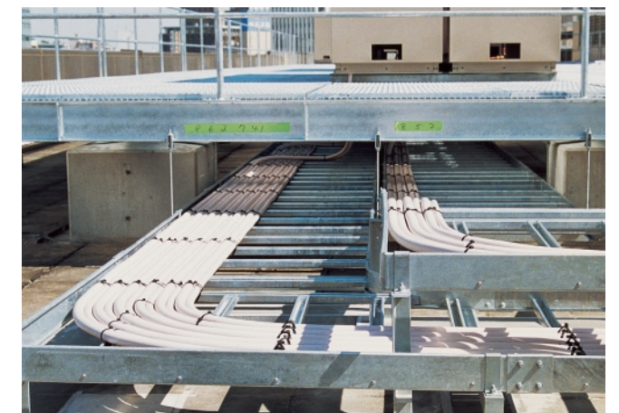
屋外の配管状態
