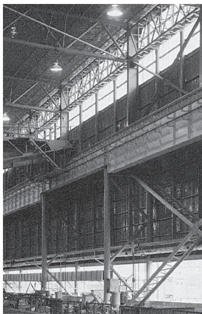
3 相垂直配置の剛体トロリ線路 (屋内支持碍子：ドラム型使用)
