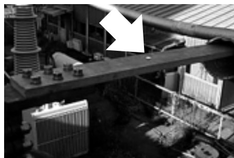
写真2 ボタンメモリー取付状態 Button-Memory installed on main circuit
