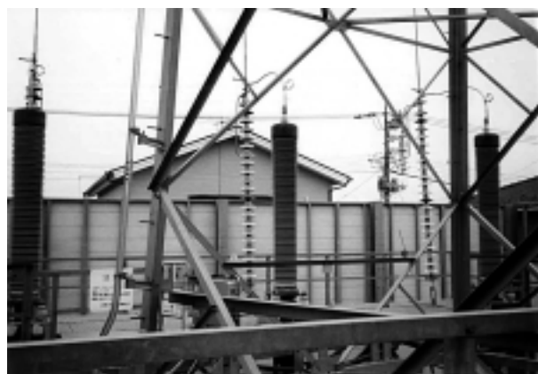
写真1 小合線鉄塔横に設置された複合がい管 EB-A Outdoor termination with composite hollow insulator at Koai-Line
