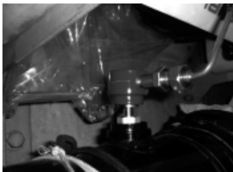
図3 活線採油コネクタからの採油例（活線採油コネクタに防食処理を施す前の写真） Sampling of insulation oil using the on-line sampling connector (Before corrosion protection is applied on the connector)
