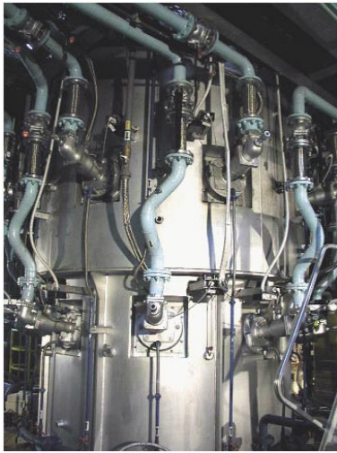
図2 シャフト炉外観 Appearance of shaft furnace
