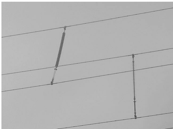
写真5 桜ヶ丘線取り付け状況 SR inter-phase spacer in Sakuragaoka line.
