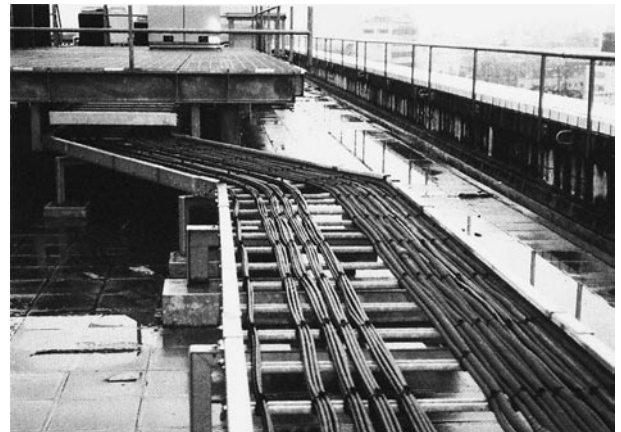
図 2 サーモインチューブ SN-UGA の屋外配管例 ThermoinTube SN-UGA laid outdoor.
