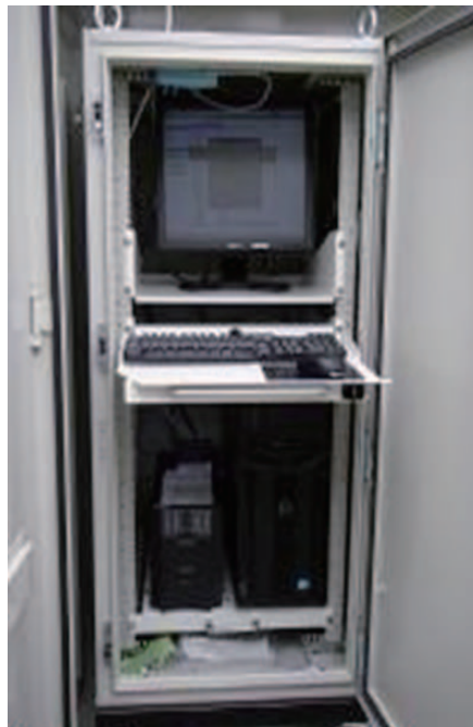
図3 いのちのたび博物館 10 kW 蓄電池システム用BMU BMU for 10kW battery system in Kitakyusyu Museum of Natural History & Human History.
