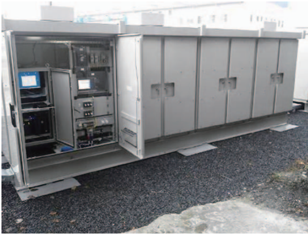
図5 前田地区300 kW 蓄電池システム用BMUおよび ウルトラバッテリー（親局側） BMU for 300kW battery system and the UltraBattery in Maeda Area. (Master station side)
