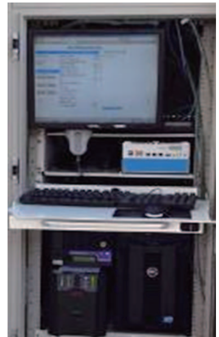
図4 いのちのたび博物館 100 kW 蓄電池システム用BMU BMU for 100kW battery system in Kitakyusyu Museum of Natural History & Human History.
