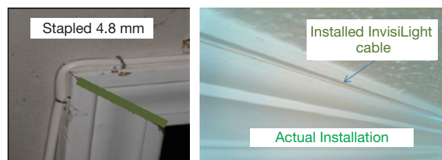
図3 既存建物への超低曲げ損失シングルモード光ファイバの敷設例 Examples of the deployed ultra-bend-insensitive single-mode optical fiber in the existing buildings.
