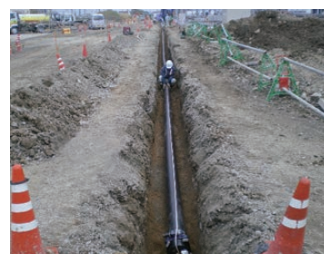
④上下水道用配管
