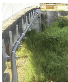
②橋梁添架配管
