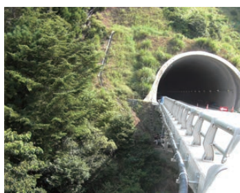
③トンネル消火配管
