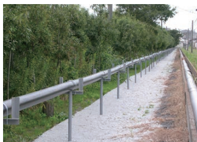
⑤工業用水配管
