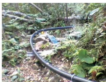
①山間部配管
