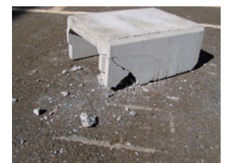
欠け、ひび割れ発生
