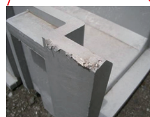
落下部に表面傷のみ、実用上支障なし
