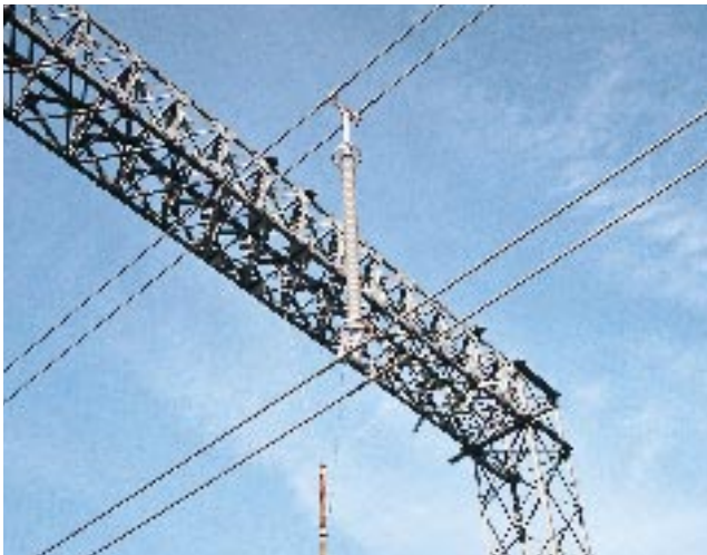
154kV用 複導体
