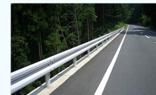
ガードレール
