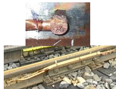
銅テルミットレールボンド溶接部
