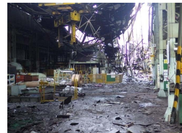
被害直後の状況
