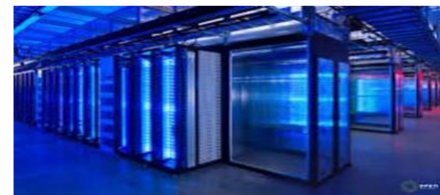
データセンタ冷却システム
