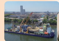
海底用電力ケーブル 国内トップクラス
